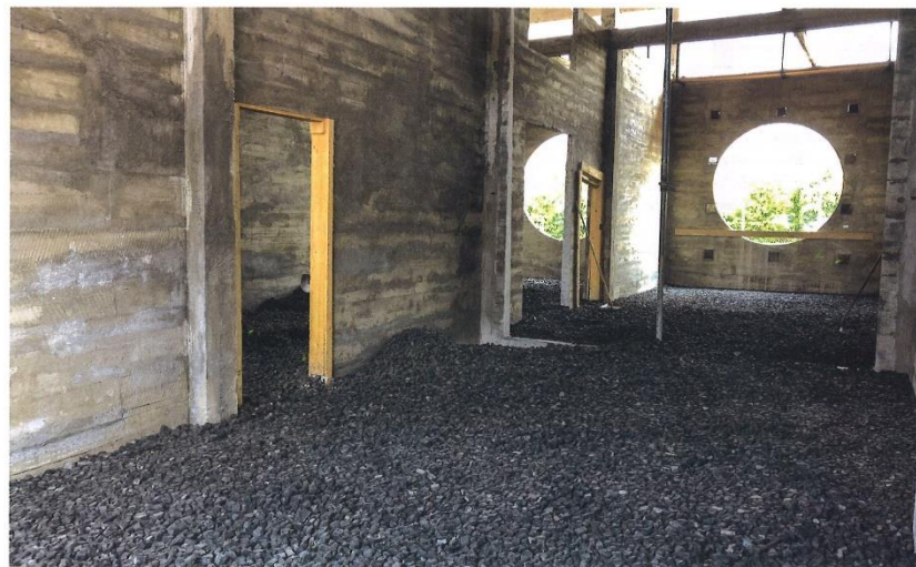
Auffüllung der pyramidenförmigen Silotrichter mit einer Leichtschüttung, die zugleich als Schalung für den Fussboden fungiert.
